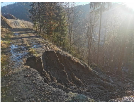
Forststraße Dopplleiten (Gemeinde Lembach) – Rutschung Dezember 2023 Foto: Forsttechnischer Dienst BH Rohrbach
