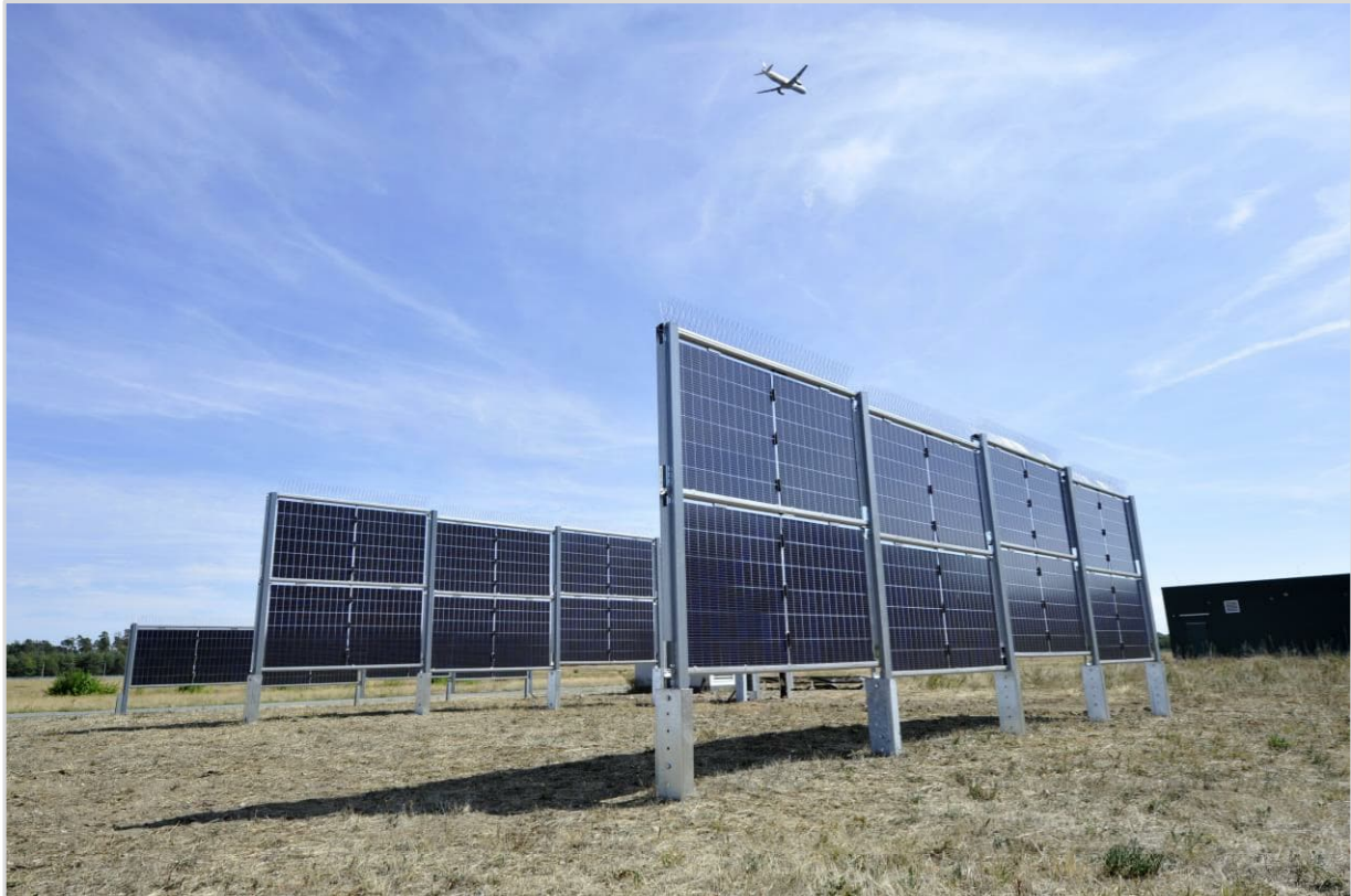
Abbildung 19: Pilotanlage mit bifacialen Modulen am Flughafen Frankfurt (© Fraport AG)
