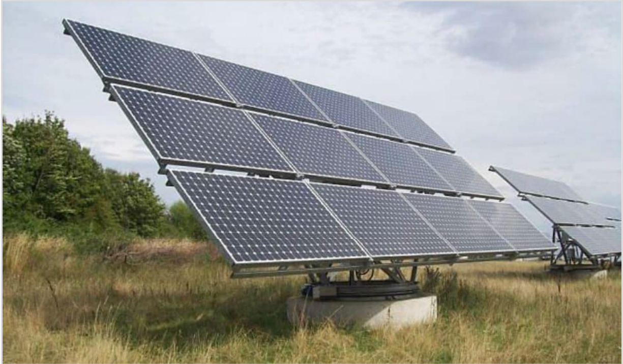
Abbildung 5: Nachgeführte Anlage (2-achsig), Gründung mit Betonfundament, weiter Stand, deutliche Modulabstände (Quelle: Photovoltaikforum GmbH www.photovoltaikforum.com , abgerufen am 18.01.2023)
