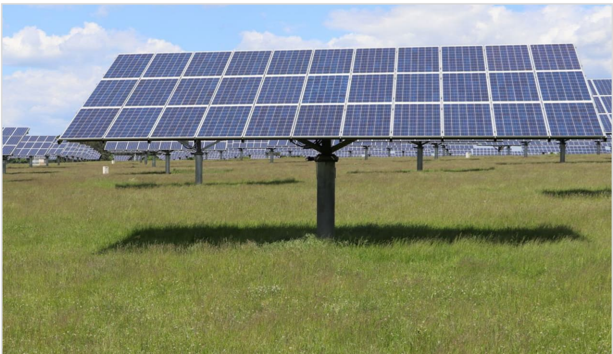
Abbildung 6: Nachgeführte Anlage (2-achsig), Gründung mit Schraubanker, weiter Stand, geringe, vertikale Modulabstände (© Baader Konzept)
