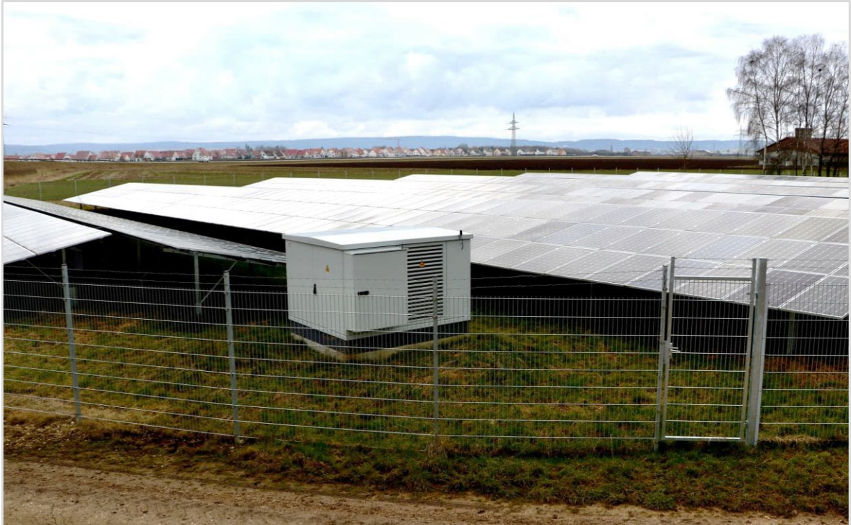
Abbildung 9: Relativ niedrige und dichte, dachartige Aufstellung der Modulreihen in Ost-West-Ausrichtung (© Baader Konzept)
