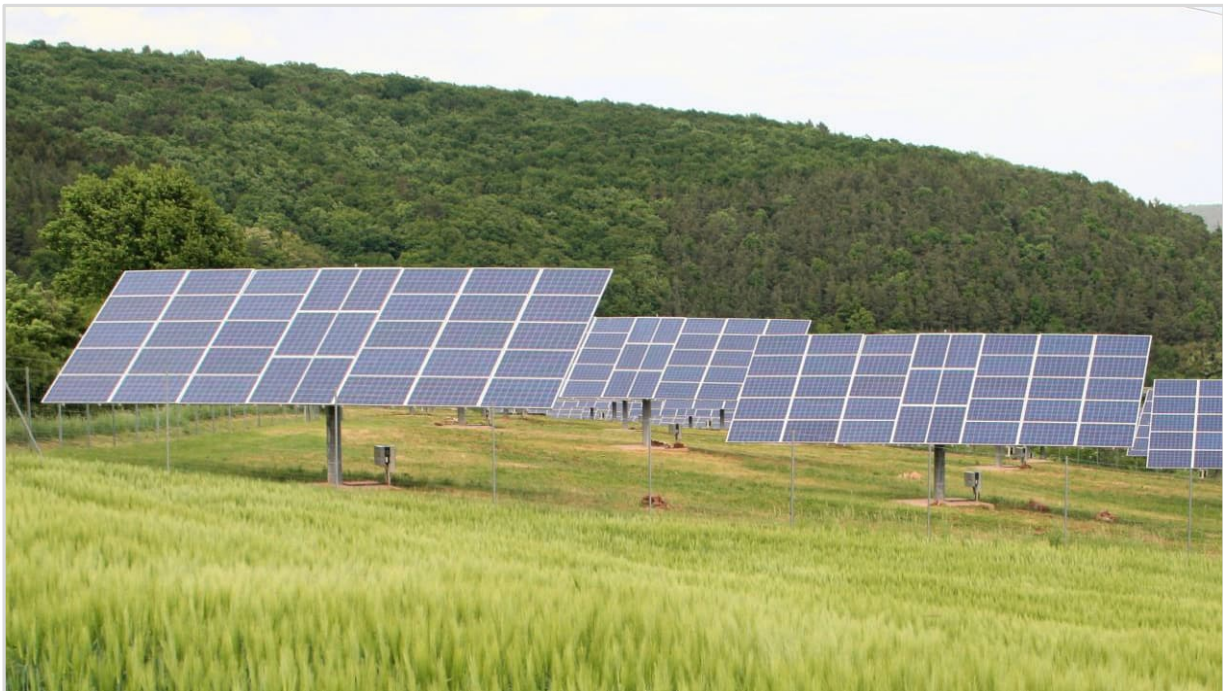
Abbildung 39: Photovoltaik-Freiflächenanlage mit Betonfundamenten (© Schnittstelle Boden)
