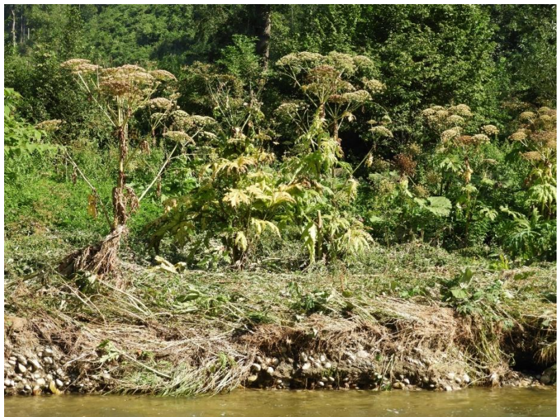
Abb. 13: Uferabbruchkante an Strecke A nach dem Hochwasser Anfang August; 9.8.2020; vgl. auch Abb. 5. Foto: A.Ch.
